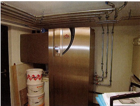
Pas d'isolation: Le canton exige la réparation du défaut
