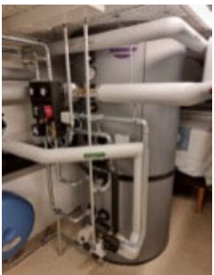
Isolation partielle: Le canton exige la réparation du défaut
