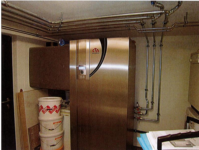
Heizleitungen im Heizraum
