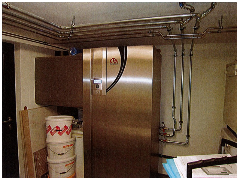
Conduites de chauffage
