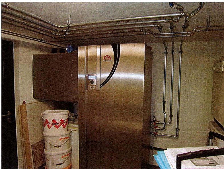
Câbles chauffants dans la chaufferie
